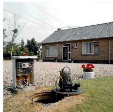
Eksempel på pumpebrønd
